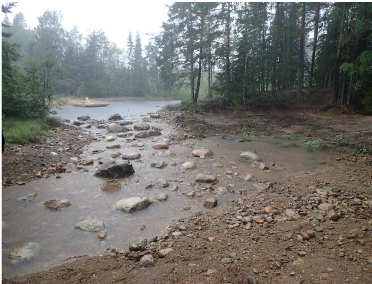
Figur 42. Exempel på partiell utrivning Gräntjärnsdammen och återställning av strömområdet. Vattennivån kunde med detta utförande bevaras nära intakt.
