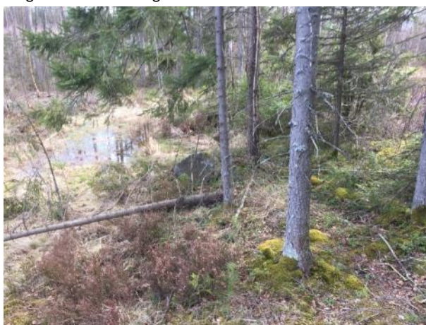
Figur 77. Visst läckage förekommer längs dammkroppen.
