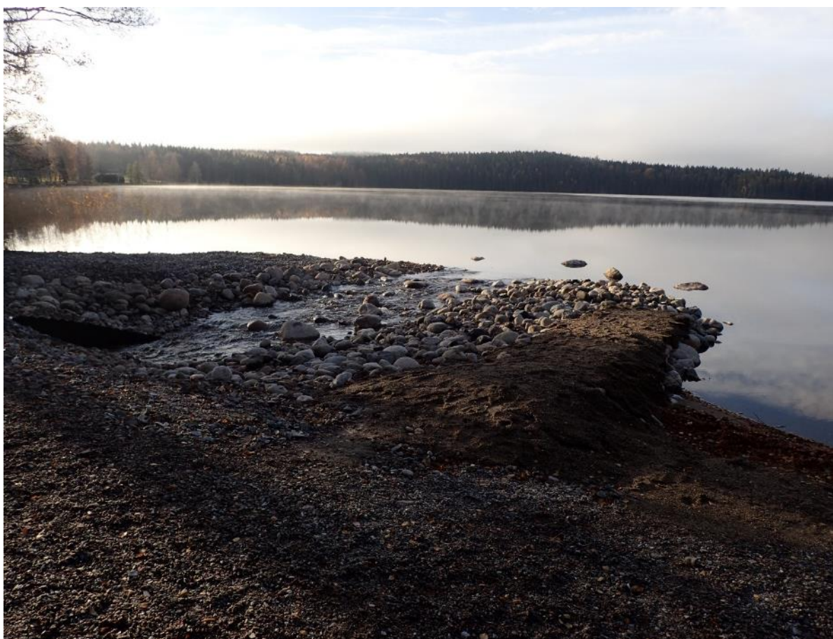
Figur 47. Exempel på partiell utrivning Bredsjödammen och återställning av strömområdet. Vattennivån kunde med detta utförande bevaras nära intakt uppströms.
