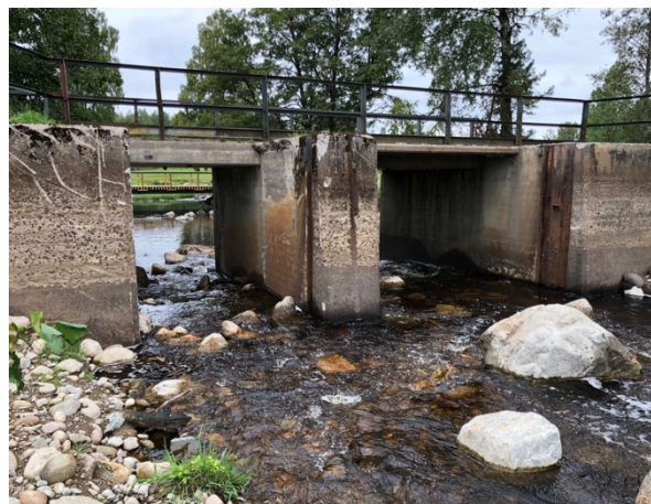
Figur 64. Utrivna utskovsluckor och trösklar.
