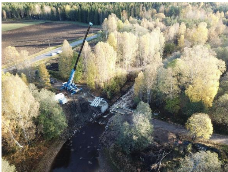
Figur 26. Utriven damm Hedströmmen. Notera stenfyllning som sträcker sig ca 30 m uppströms dammläget.
