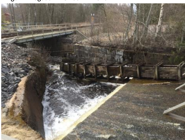
Figur 6. Hagadammen denilränna och utskovskanal.
