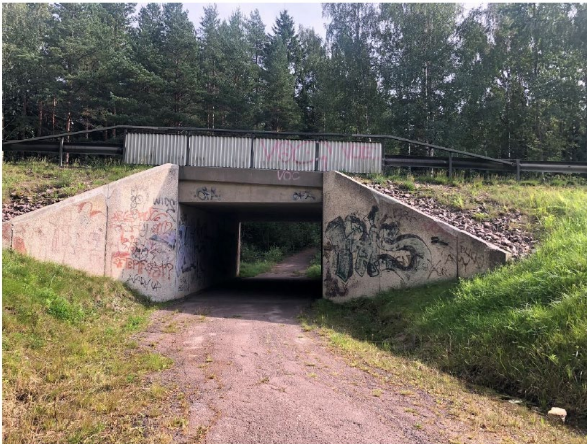
Bild: Befintlig gång och cykelbana under riksväg 26 genom "Norra Porten". Inledande trafikutredning Harberget, Förslag till väganslutningar till det nya regementet A9 på Harberget i Kristinehamns kommun, Sweco 2024-08-12.
