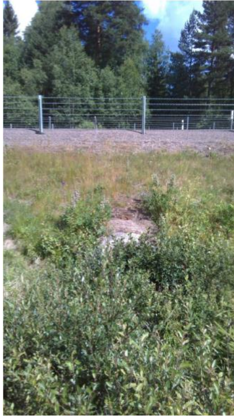
Foto: BTG1000 under E18. Rensning av sly vid inloppet bör säkerställas (Foto: Kristinehamns kommun, juni 2023). Dagvattenutredning A9, Harberget Kristinehamn Fortifikationsverket, Sweco 2023-08-29.
