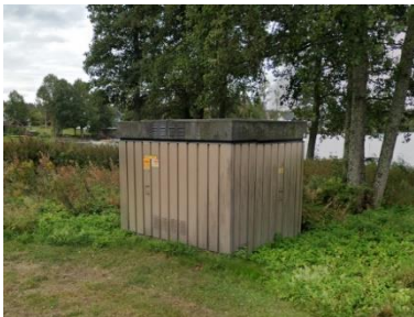
Bild: Transformatorstation invid Gräsviksvägen
