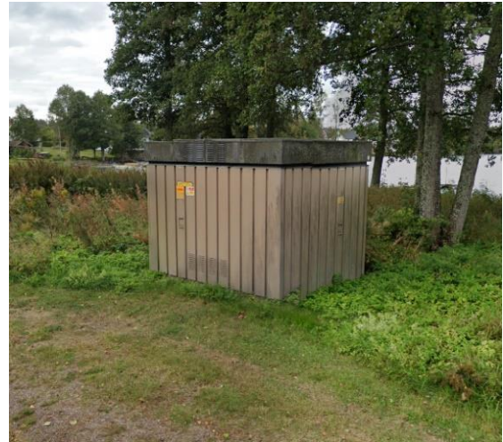
Bild: Transformatorstation i områdets södra del
